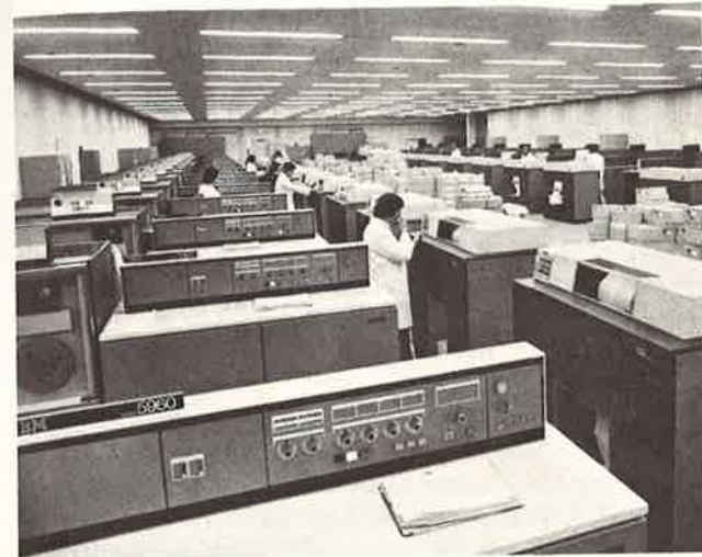
Abb. 1.2.3/4: Druckerraum der DATEV eG mit 30 installierten Schnelldruckern
